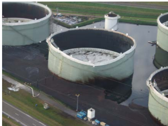
写真 基礎破壊の結果傾斜しているタンクの状況
