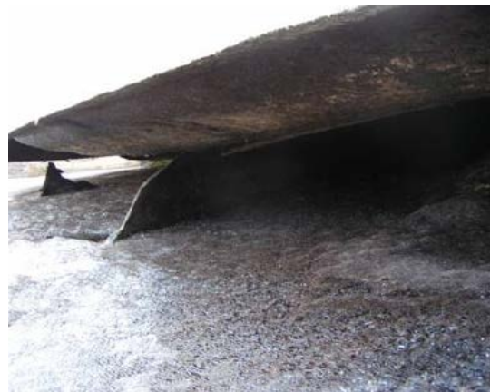
写真：その後底板が破断した状況
