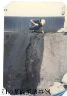
図 2.6.5 国内での基礎の損壊事例 (大規模流出に至らなかったもの)
