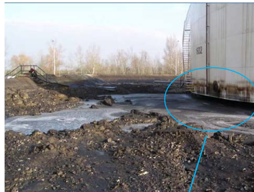
基礎が変形洗掘された (1月12日8時)
