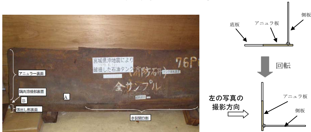
図 3.3.1 昭和 53 年宮城県沖地震で破断したタンクのアニュラ板裏面の腐食状況
