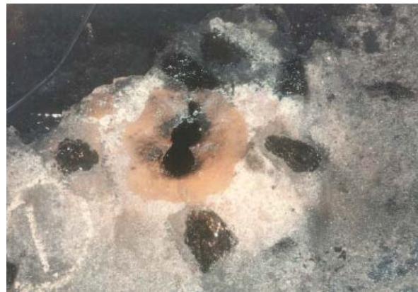
内面腐食貫通孔の例（事故事例 90）
