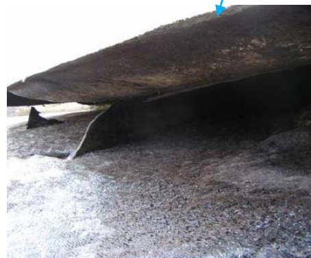
基礎が洗掘された結果、底部の下に隙間を生じ、アニュラ板が破断している状況
